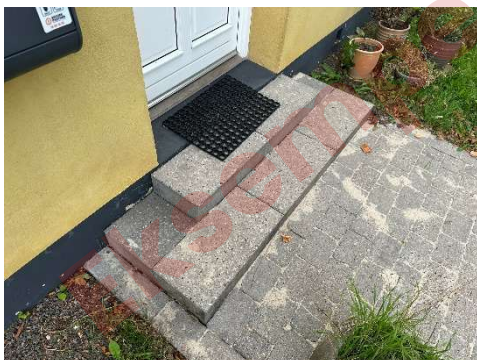
Ved indgangsdørene mod nord samt ved terrassedørene er der fritlagte natursten, uden umiddelbare tegn på problemer.
