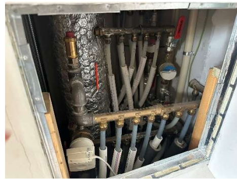
Her ses installationsskabet i en af lejlighederne.
