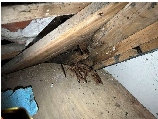
Ved frontispicen mod nord er træværket tidligere fugtskadet og nedbrudt. På modsatte side er træet yderligere påvirket, enkelte steder med fugt.
