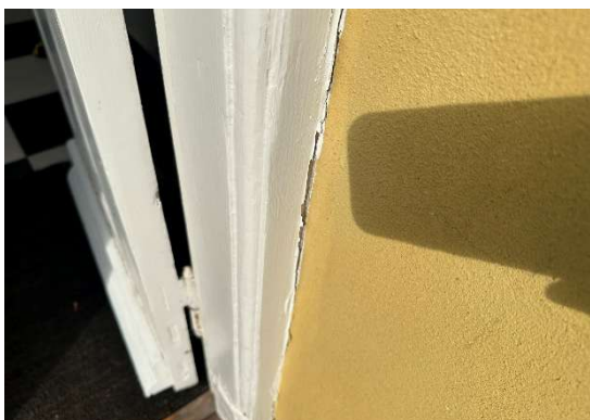
Ved døre og vinduer er der mørtelfuger fremfor silikonefuger, hvilket passer til husets karakter. Fugerne bør dog efterses, udbedres og males.
