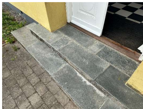
Trappetrinnene i opgangen er udført i støbt beton med belægning af naturfliser. Fastgørelse og beton bør kontrolleres.
